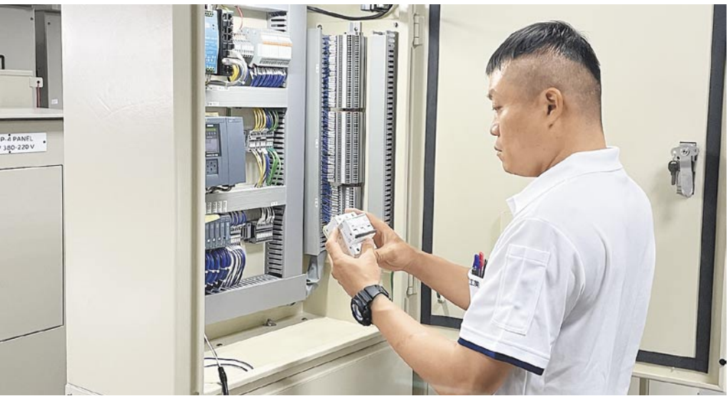
●汎武電機具備能源局401原製造廠家資格，並自有TAF認證實驗室，以製造、品管與測試能力，支持設備品質與安全要求。圖／業者提供
